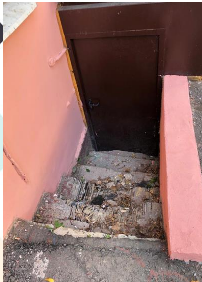
Не восстановлены ступени спуска в подвал
