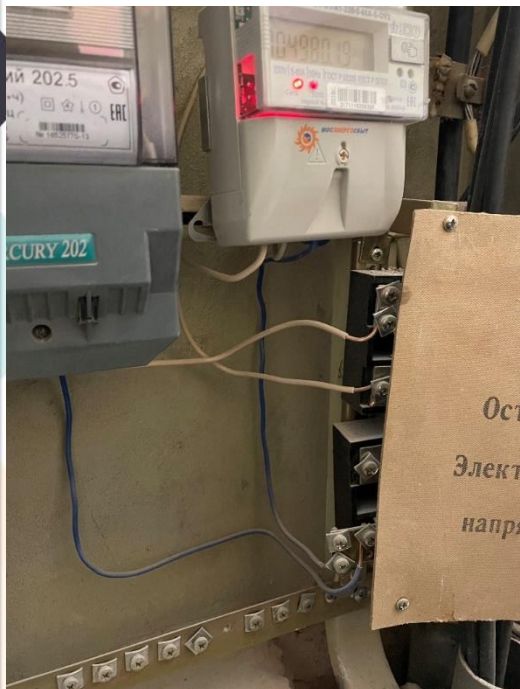
Несоответствие коммутации проводов требованиям ПУЭ
