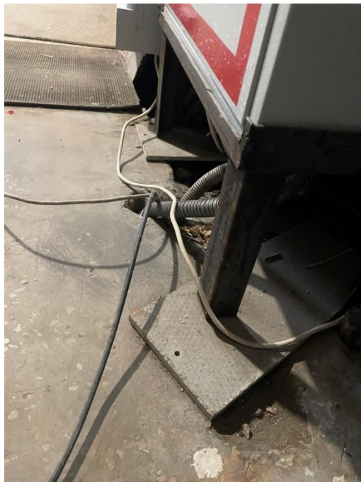
Не закреплены шкафы ВРУ
